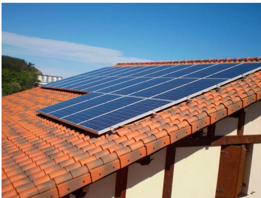
Ilustración 12: Instalación solar fotovoltaica.
