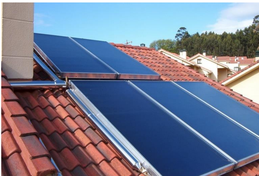
Ilustración 11: instalación solar térmica.
